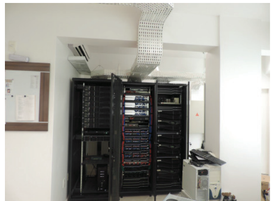
Rack de equipamentos (servidores)
